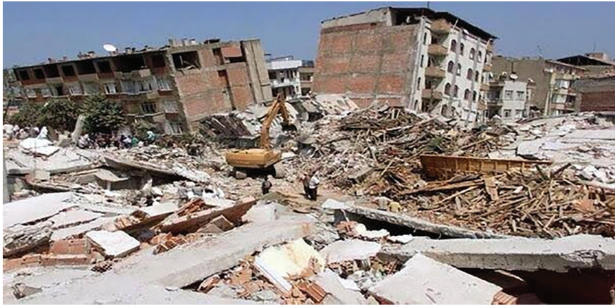
شكل (٢٨) يوضح الدمار الذي خلفه زلزال مدينة إزميت عام ١٩٩٩م
