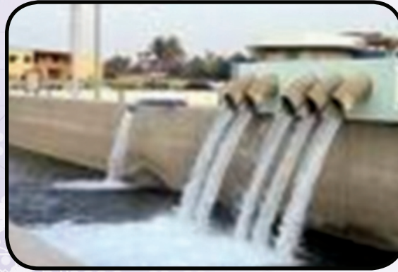
شكل (٥-١٣) مياه الفضلات
